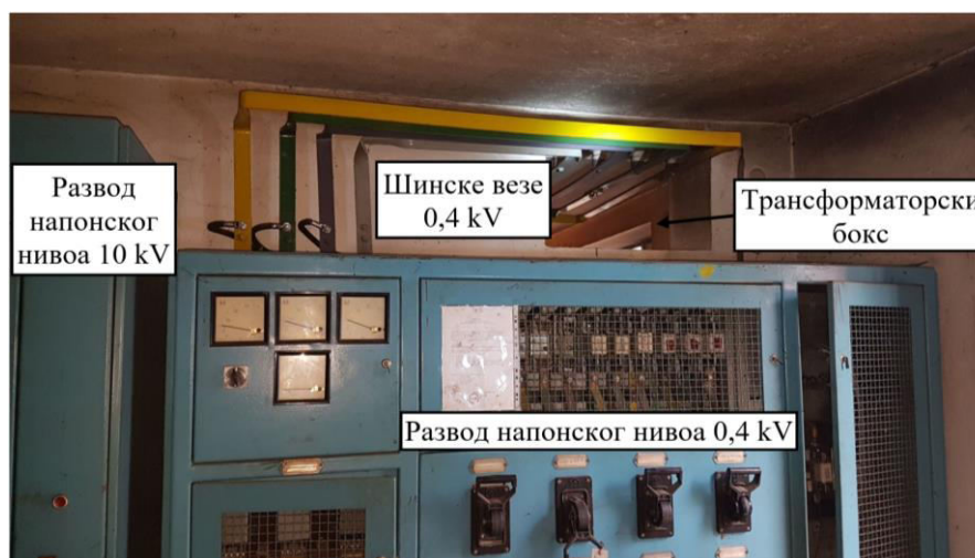
СЛИКА 3 – Шинске везе напонског нивоа 0,4 kV које повезују трансформатор и развод 0,4 kV (посматрано из просторије са разводима)
