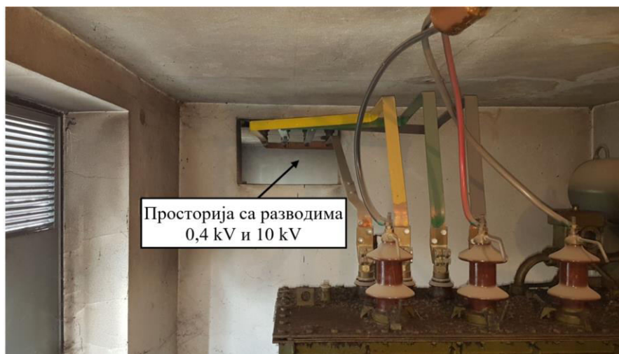
СЛИКА 2 – Шинске везе напонског нивоа 0,4 kV које повезују трансформатор и развод 0,4 kV (посматрано из трансформаторског бокса)
